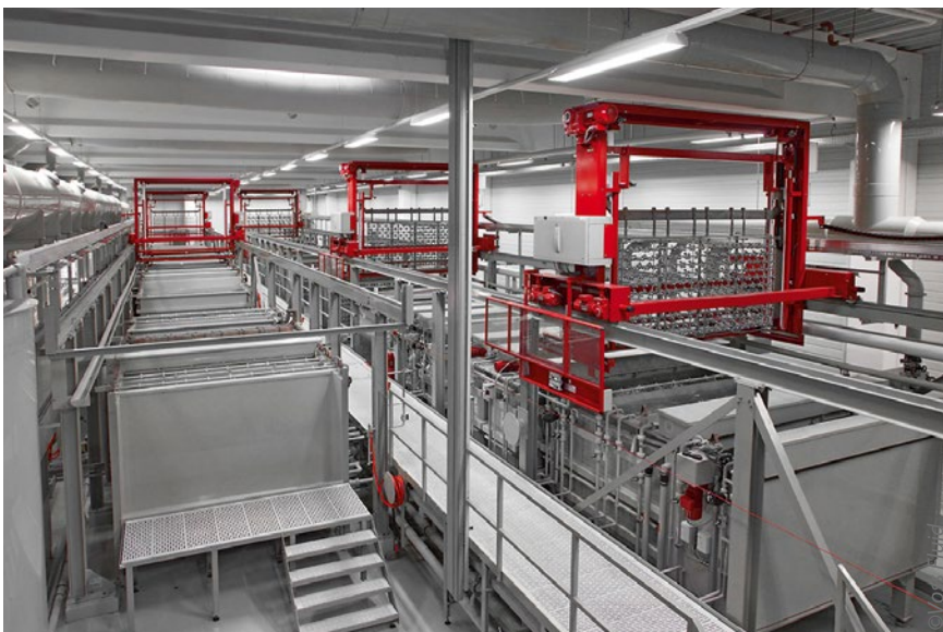
Die werkseigene Galvanik von Voss Fluid zählt zu den modernsten Anlagen Europas und ist ideal auf die internen Prozessschritte beim Beschichten ausgelegt
